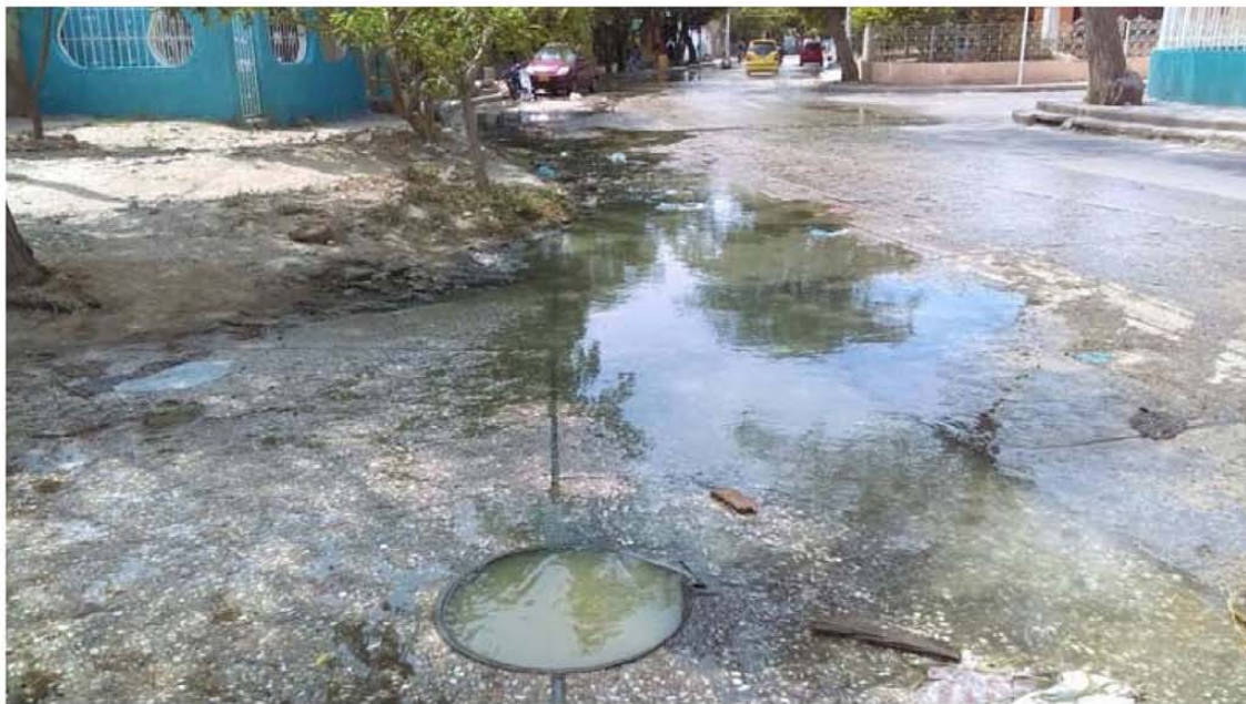
Las alcantarillas en diferentes partes de Riohacha, casi siempre están rebozadas.
